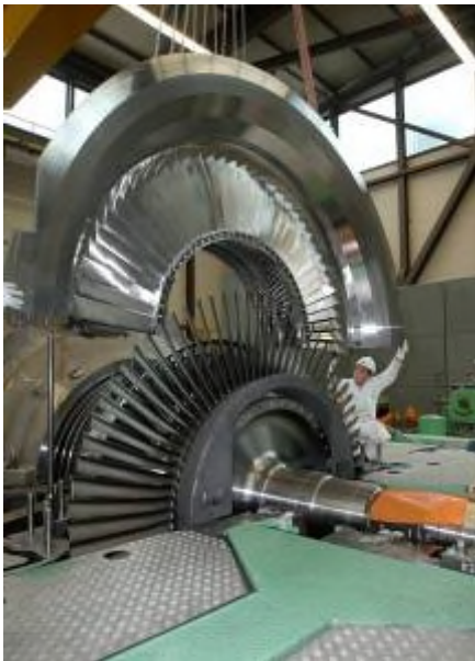
Blick ins Innere der Turbine während der Revision
