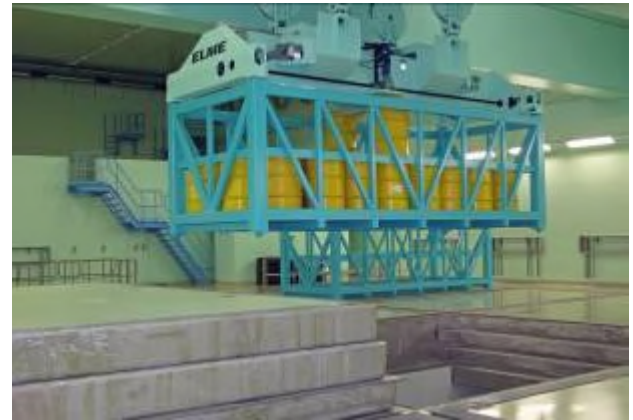
Halle de stockage des déchets de moyenne activité
