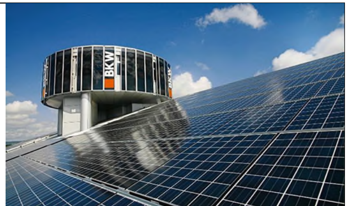
Le toit du Stade de Suisse de Berne comporte une des plus grandes centrales solaires de Suisse.
