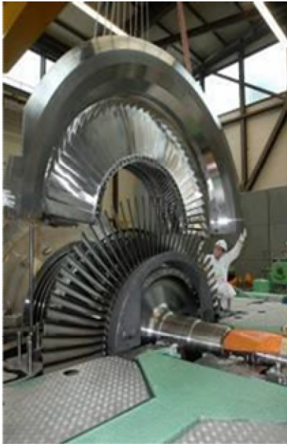
Coup d'œil à l'intérieur de la turbine lors de travaux de révision.
